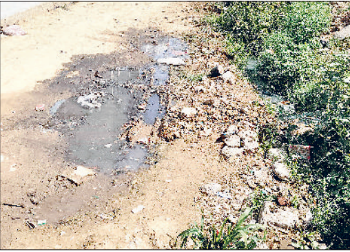
मंडी अटेली । खामपुरा में पाइपलाइन बिछाने के बाद उखड़ी पड़ी सड़क ।
